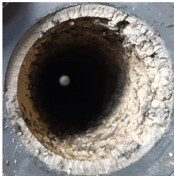
Querschnitt einer Rohrleitung mit Inkrustationen
